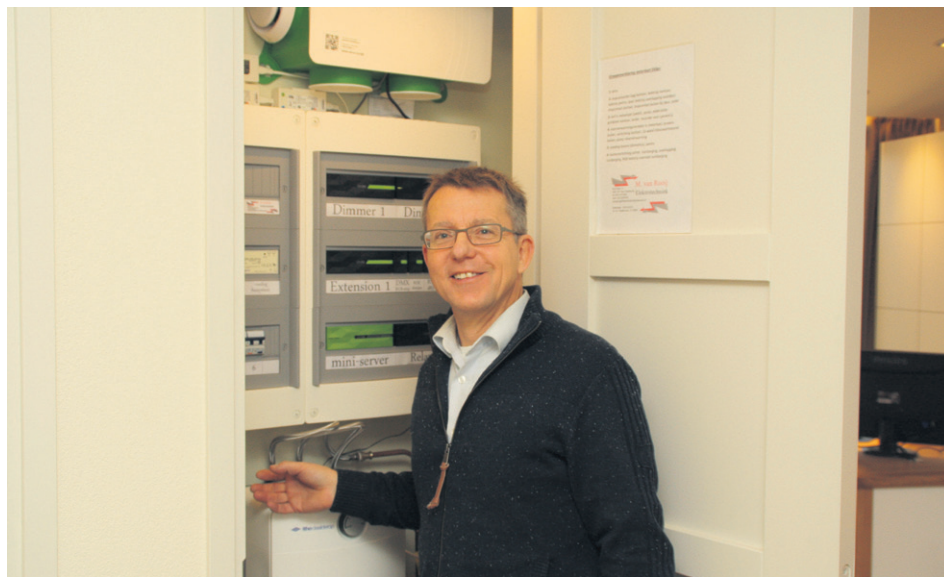
De domotica-installatie vormt het hart van het kantoor
